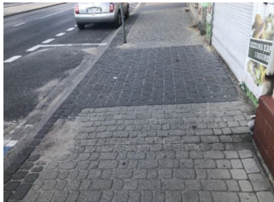
Рис. 2. Руїнування ділянки тротуару з фігурних елементів мостіння, Польща, м. Косцян
