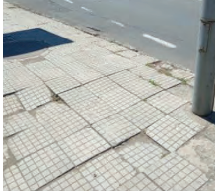
Рис. 1. Деформації ділянки тротуару з малорозмірних плит, Болгарія, Сонячний берег
