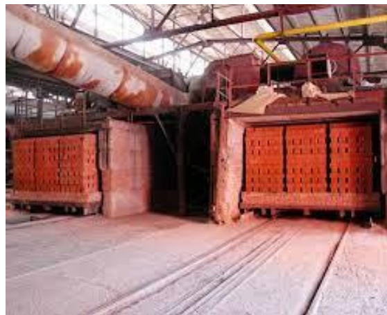
Рис. 7. Зовнішній вигляд тунельної печі
