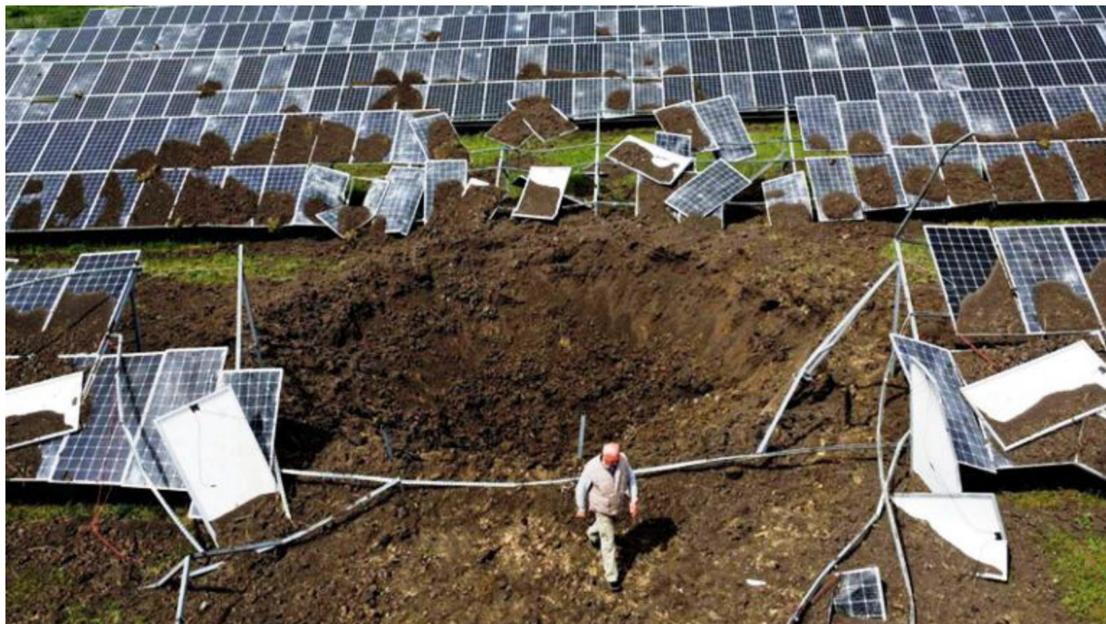
Рис. 2. Зруйнована СЕС (м. Мерефа, Харківська область) [2]
